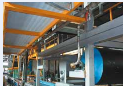
Scorcio di una linea di produzione delle membrane nello stabilimento di Ponte di Piave
